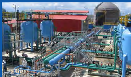
Tratamento de água Purificação e filtração de águas residuais de produção
