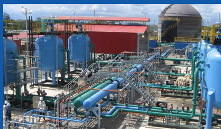
水処理 生産排水の浄化とろ過
