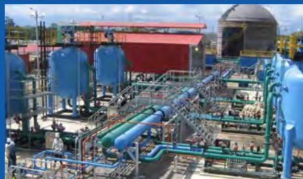
水処理 生産排水の浄化とろ過
