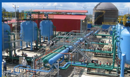
水处理 生产废水净化和 过滤
