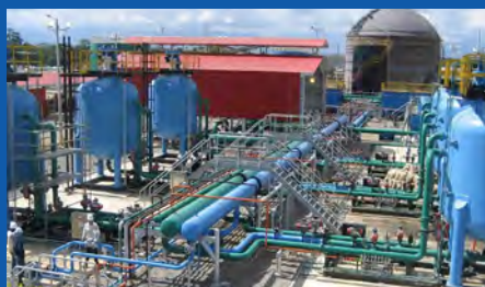
水处理 生产废水净化和 过滤
